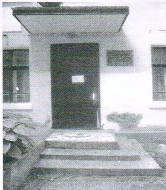
фото № 34 . Дверь входная – здание № 1
